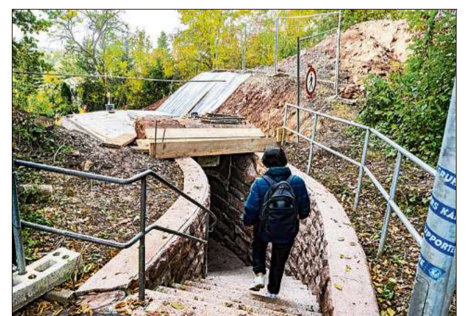
Die Rollgrabenunterführung hat eine Sanierung dringend nötig. Foto: Fritsch
